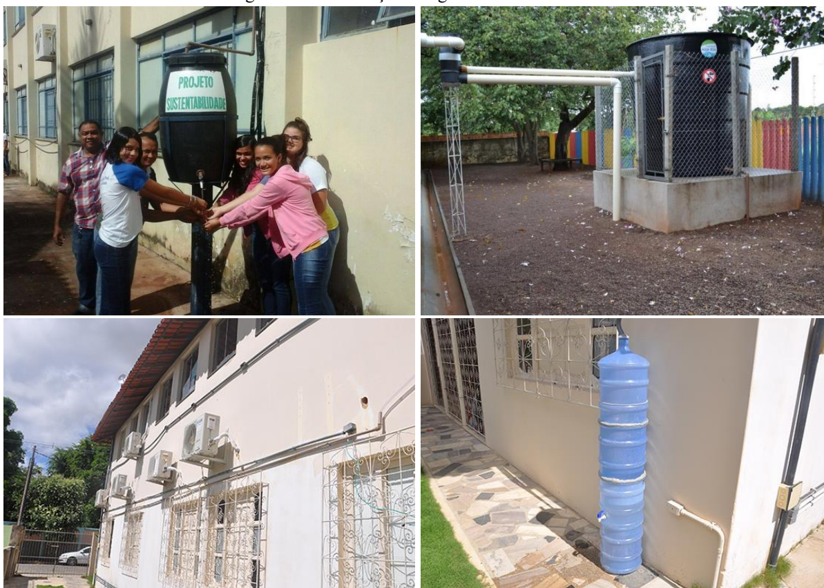
Figura 31: Reutilização da água do ar condicionado
